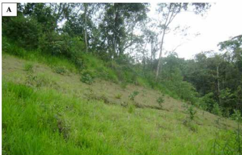
Figura 2. Encosta após a obra de estabilização finalizada no ano de 2009 (A) e na data da visita de campo no final do ano de 2012 (B).
