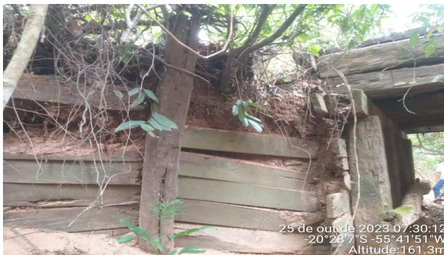
Figura 8. Contenção de terra do aterro em deterioração devido à erosão. Fonte: Elaborado pelos autores.
