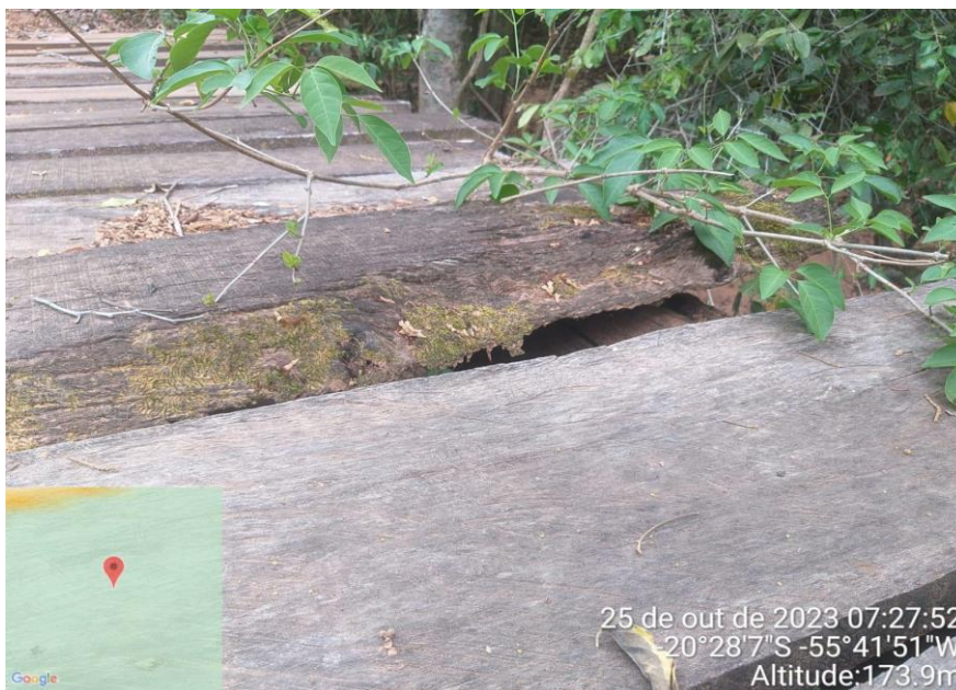
Figura 6. Aparecimento de plantas e musgos, na superfície da madeira na região superior da ponte.
