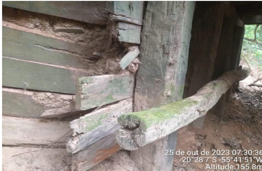
Figura 7. Degradação da madeira devido a erosão e falta de manutenção, presença de fungos. Fonte: Elaborado pelos autores.
