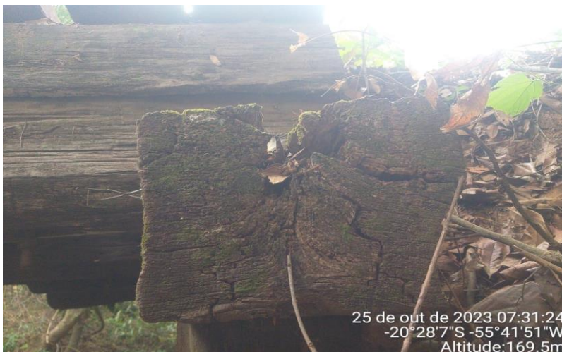
Figura 9. Deterioração devido a umidade gerando o aparecimento de fissuras e rachaduras. Fonte: Elaborado pelos autores.
