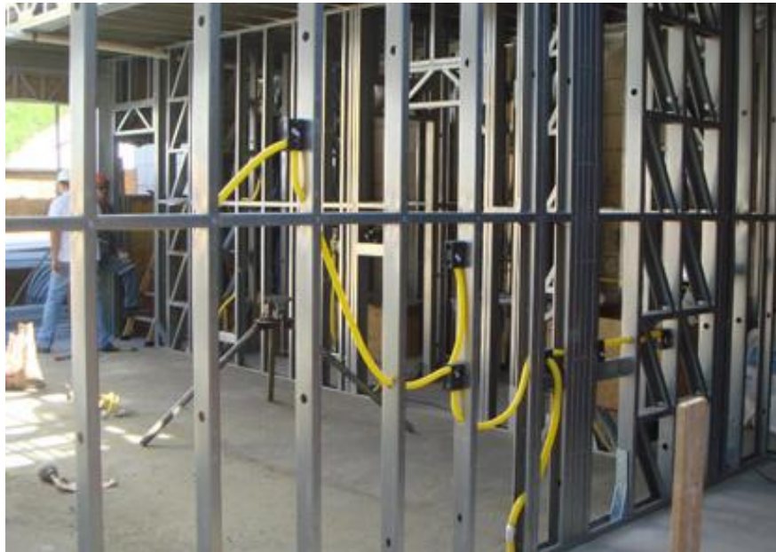
Figura 2. Furos para acomodação de tubulações (Fonte: Flasan)
