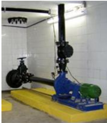
Figura 2 - Conjunto motor bomba com detalhe da interligação
