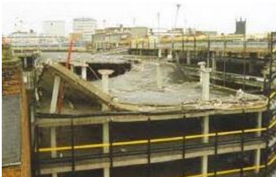
Figura 2.3 – Rompimento de laje por punção.
