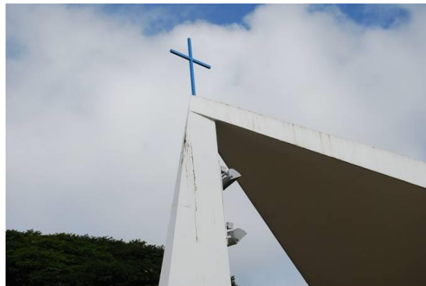
Figura 9. Detalhe do encontro do Pilar principal com a cobertura. Foto do autor.
