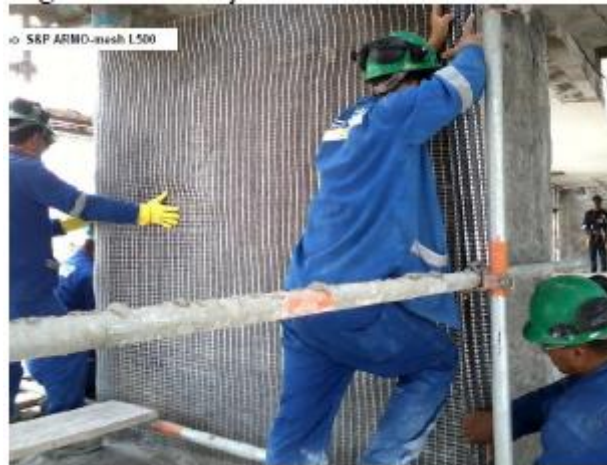
Figura 2. Reforço de pilares de concreto no estádio Maracanã (Leoni & Souza, 2013)
