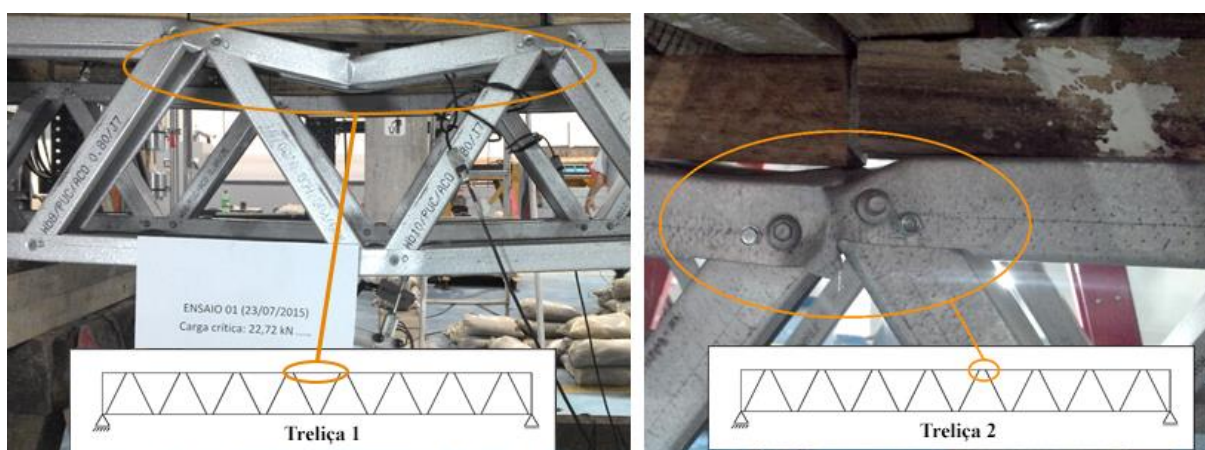
Figura 10. Posição e estado dos elementos que provocaram ruína na estrutura
