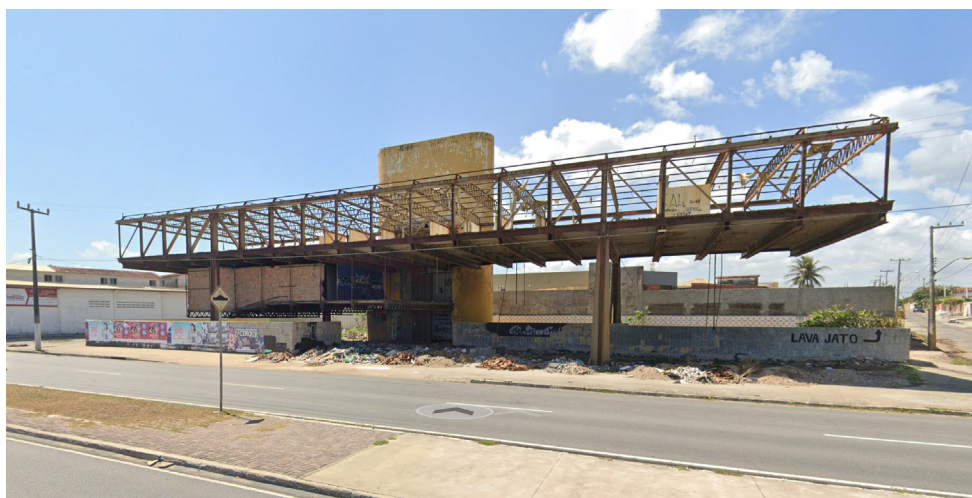
Imagem 3. Ruína do Tribunal de Contas da União no Estado de Alagoas, 2019. Fonte: Google Street View
