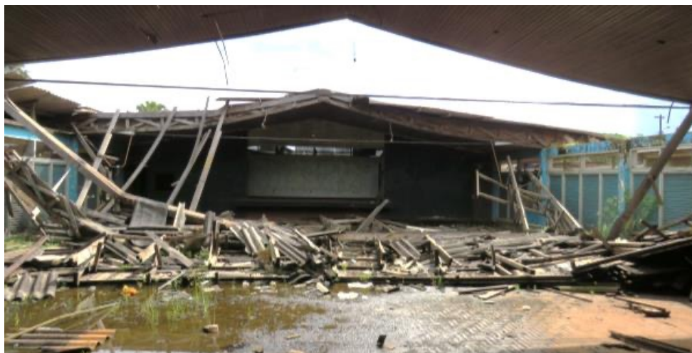
Imagem 8. Desabamento da cobertura do Clube de Serra do Navio (AP), o tempo agindo contra o patrimônio. Fonte: Fernando Moreira Diniz (foto; jun. 2017).
