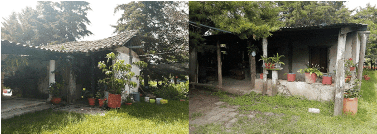
Figura 16 – Vista de la cocina y de la tienda de raya en mal estado de conservación
