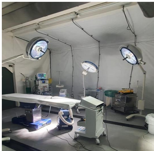
Figura 2: Interior dos módulos de um hospital de campanha.
