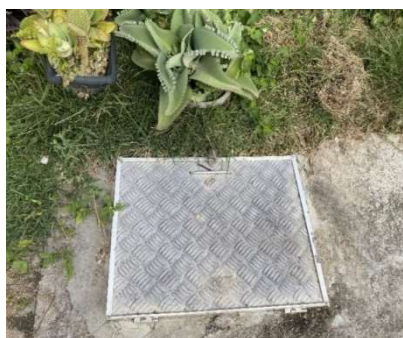
Figura 12: Tampa de alumínio em cisterna em uma das residências, estando fora do padrão estabelecido na NBR 5626 e sendo possível causa de contaminação da cisterna
