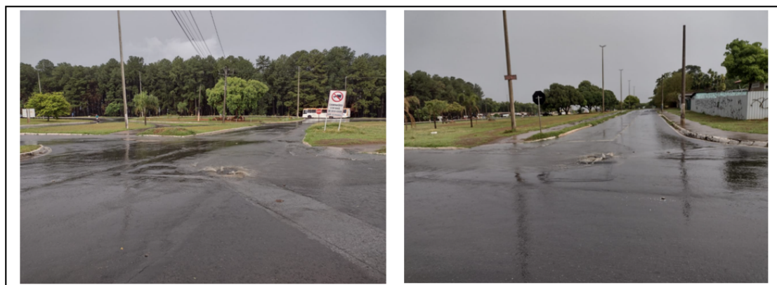
Figura 14: Fotos do PV-1.72 transbordado (Avenida Alta Tensão). Data: 16/10/2021. Horário: 12:53h.
