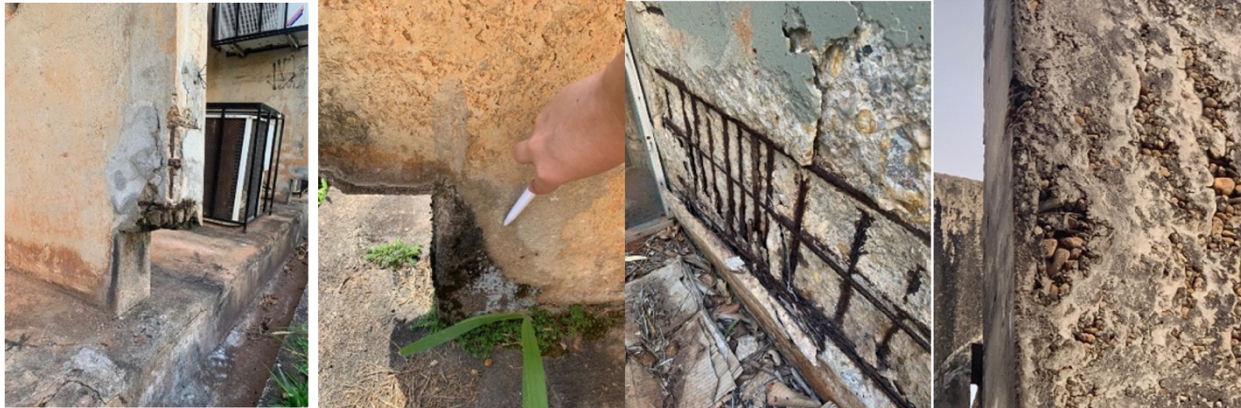
Figura 4: Manifestações patológicas identificadas durante a inspeção.
