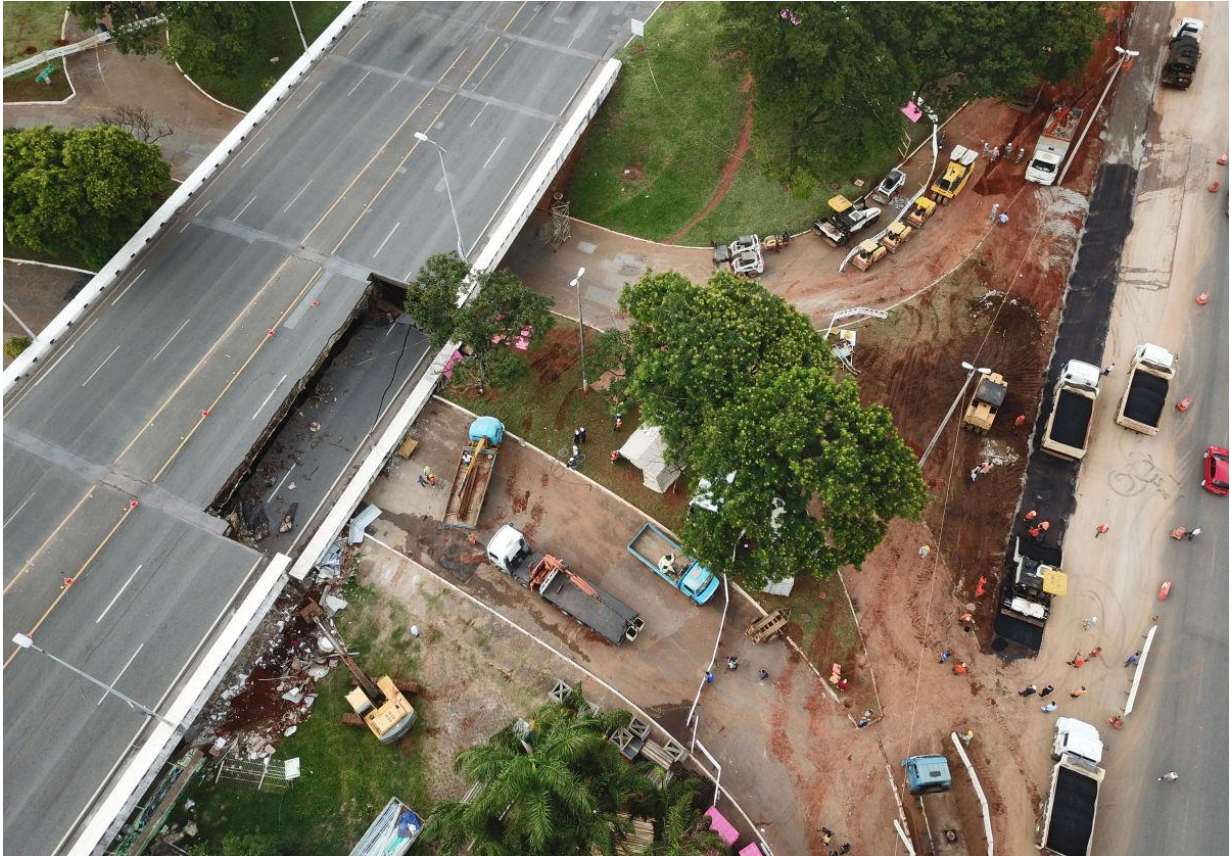
Figura 4: Colapso do Viaduto sobre a Galeria dos Estados
