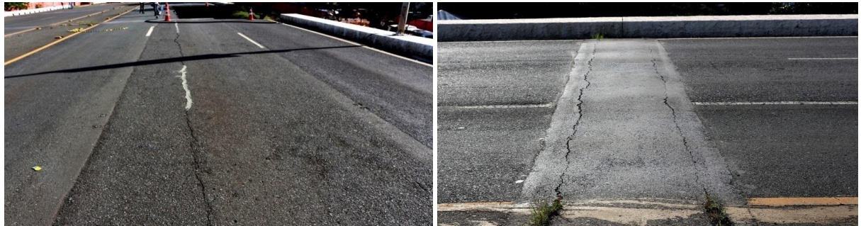
Figura 10 - 11: Fissuras no trecho do tabuleiro
