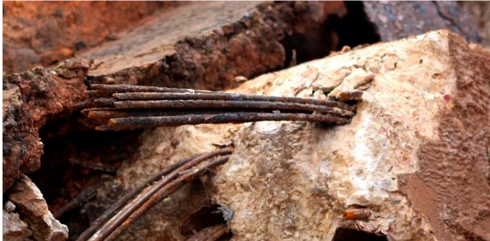
Figura 13: Corrosão das cordoalhas protendidas
