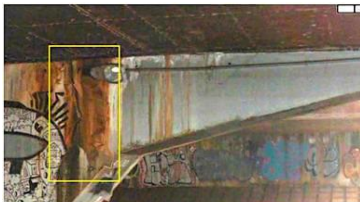
Figura 12: Fissuras ocorridas no pilar P7 antes do colapso estrutural
