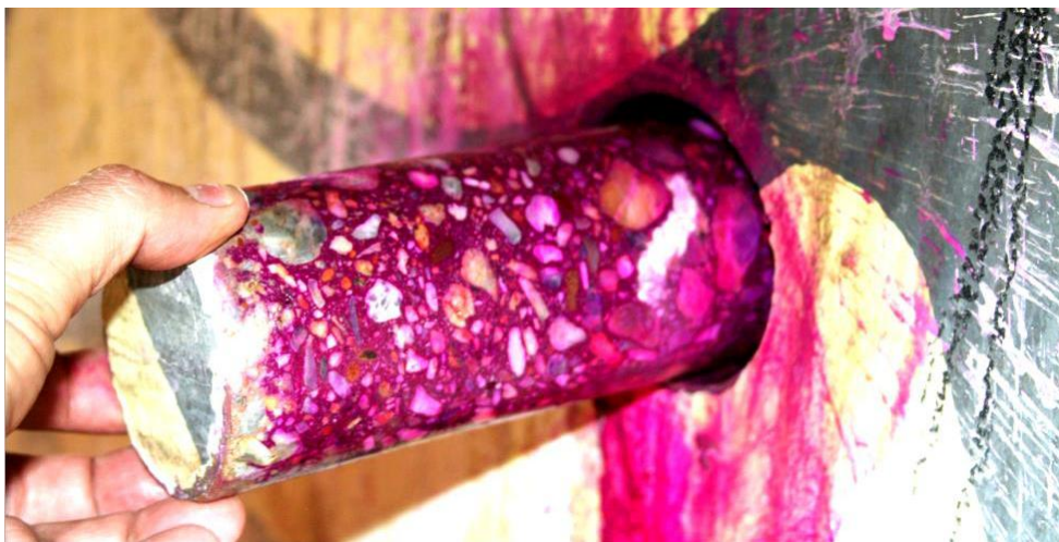
Figura 14: Extração do corpo de prova mostrando carbonatação
