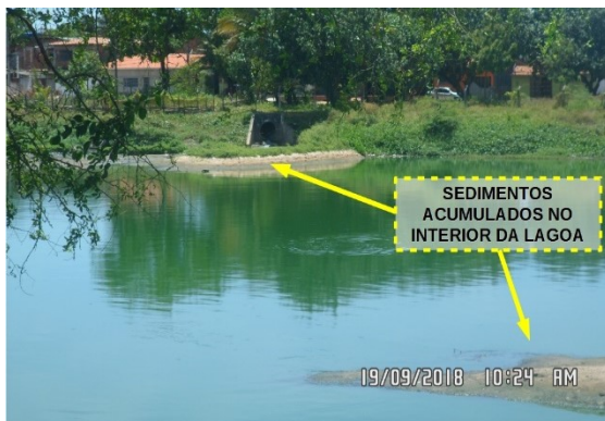
Figura 8: Presença de sedimentos acumulados
