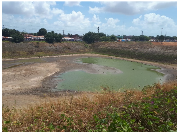
Figura 12: Vista da Lagoa de Parque dos Coqueiros, com problemas estruturais e líquido de coloração esverdeada.
