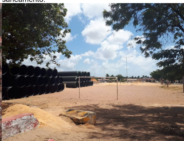
Figura 11: Espaço destinado à prática esportiva ocupado por tubulação durante a obra de saneamento.
