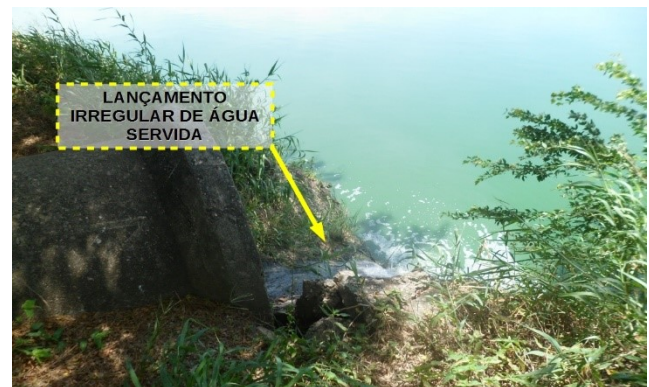
Figura 9: Lançamento irregular de água servida
