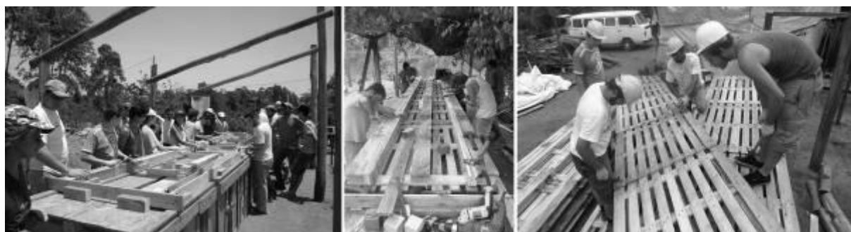
Figura 7: Os painéis de cobertura foram produzidos a partir da reutilização de paletes de madeira. Parte deles foram desmontados e suas ripas foram utilizadas na confecção das vigas laminadas pregadas, posteriormente fixadas aos paletes inteiros, constituindo assim os painéis de cobertura. A mesa de produção foi construída com madeiras de descarte doadas por uma indústria da região junto com os paletes.
