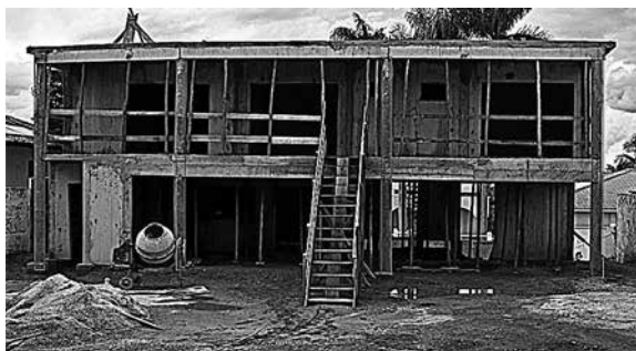
Figura 25: Pilares fora do prumo.
