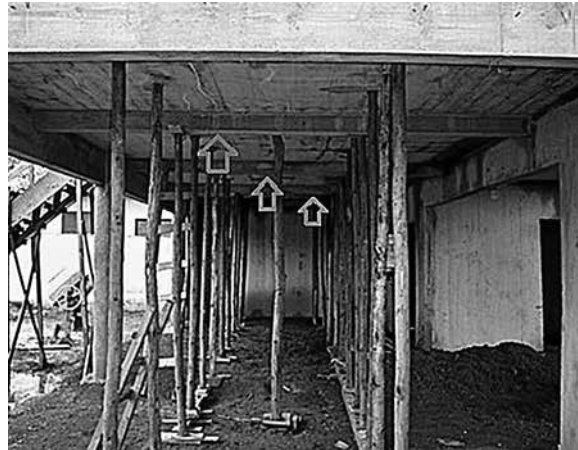
Figura 12: Vigas feitas para reforço sem ancoragem correta.
