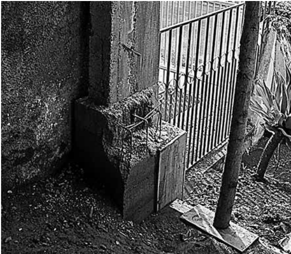
Figura 9: Fundações com armadura exposta.
