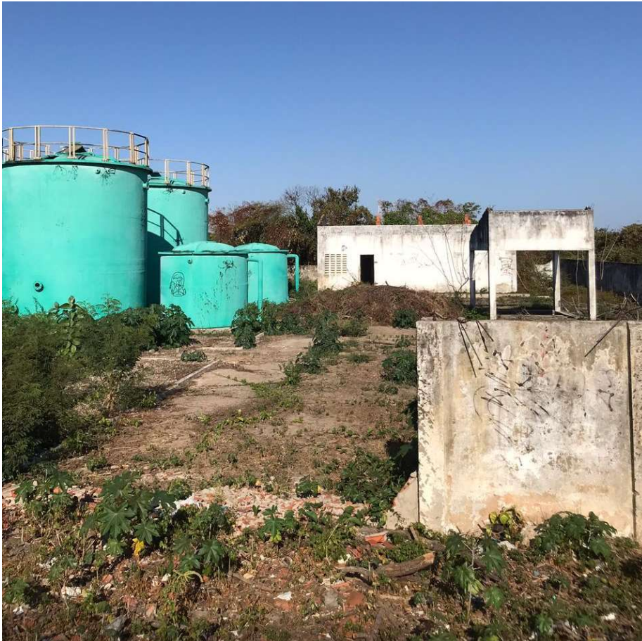
Figura 7: ETE do Tatumundé, localizada no Grande Bom Jardim e abandonada pela gestão pública. Fonte: acervo pessoal, 2020.
