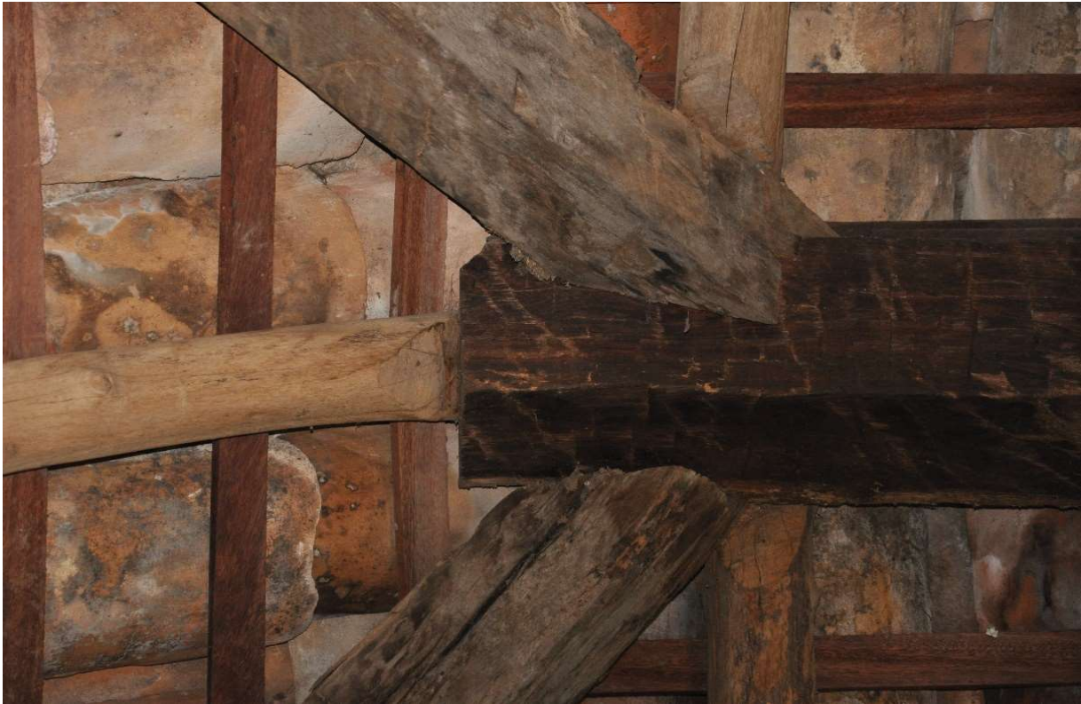
Foto: Prof. Rafael Sanzio dos Anjos. Detalhe da cumieira de madeira de um telhado tradicional. Pirenópolis – Goiás, 2015.
