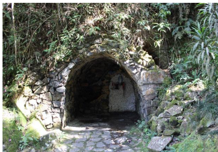
Imagem 12: Uma das grutas, localizada na parte inferior do conjunto, do lado esquerdo. Essa gruta foi recentemente reformada e novas pedras inseridas em seu desenho. Fotografia de Cristiane Magalhães, jun. 2022.
