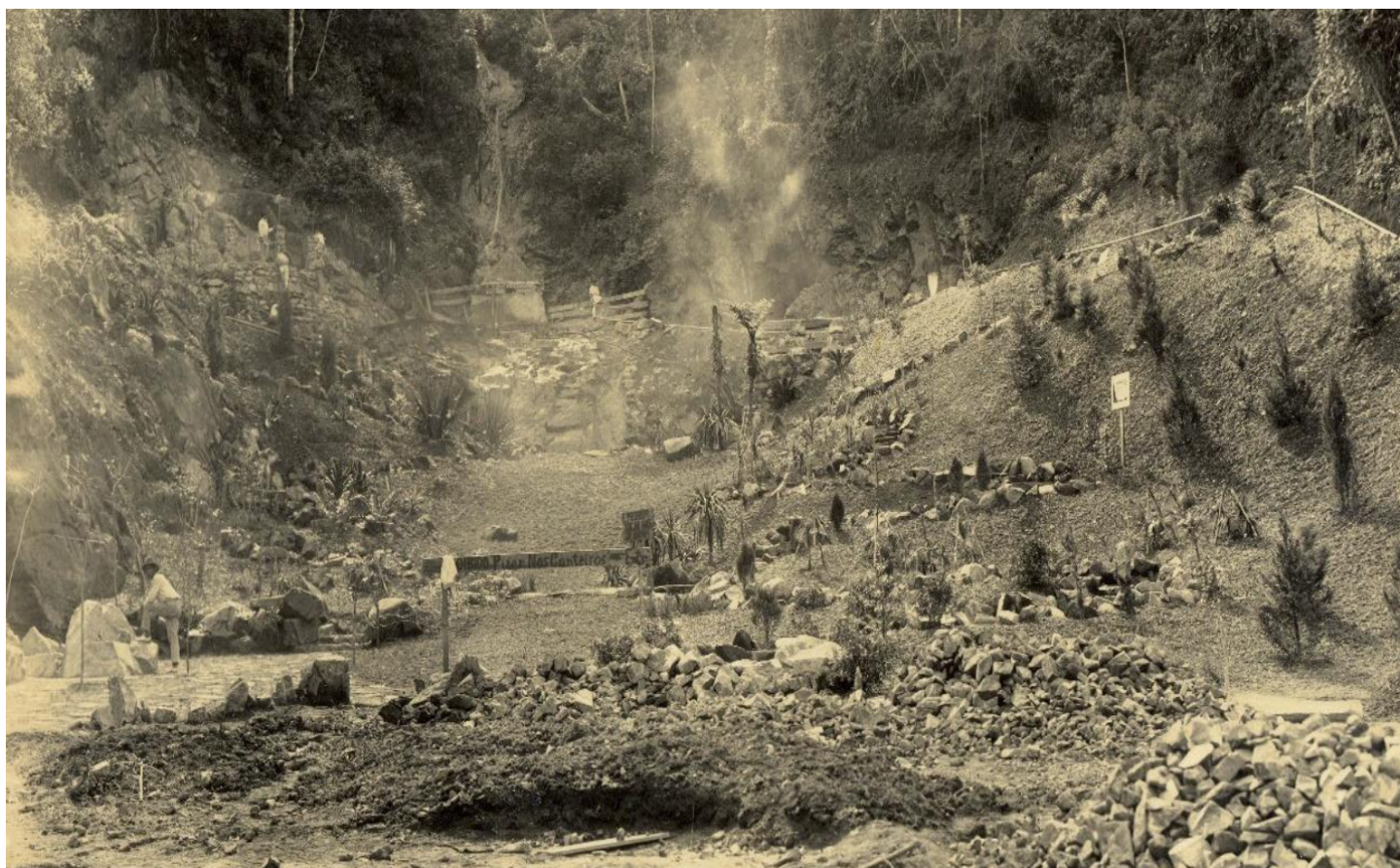
Imagem 08: Fotografia datada de 20 de julho de 1928 ilustra as obras de Dierberger na Fonte dos Amores. Acervo do Museu de Poços de Caldas.
