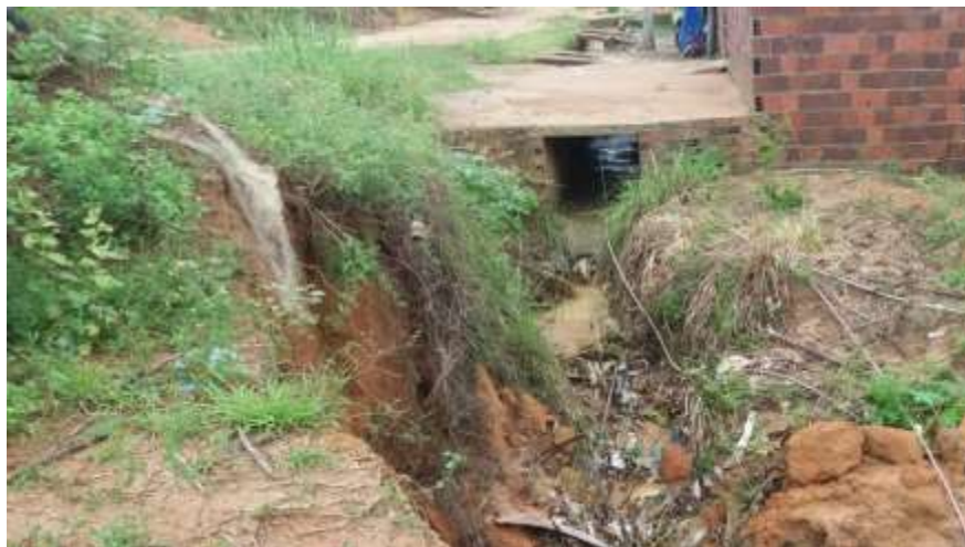
Figura 5 – Drenagem da via direcionada para o canal da erosão
