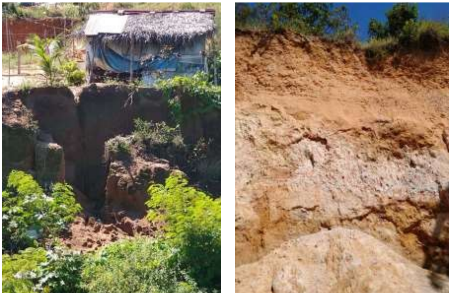
Figura 7a e 7b – Movimentos de massa, queda de bloco e deslizamento
